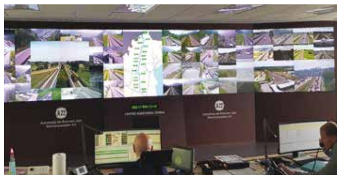
1. Il cuore del Cau, il centro di controllo di A22
