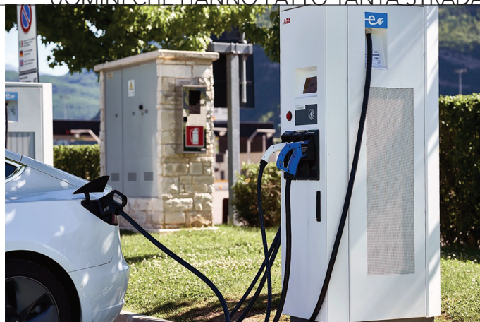
5. Una colonnina per la ricarica dei veicoli elettrici
