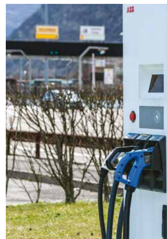
2. Le colonnine elettriche in A22 sono 76
