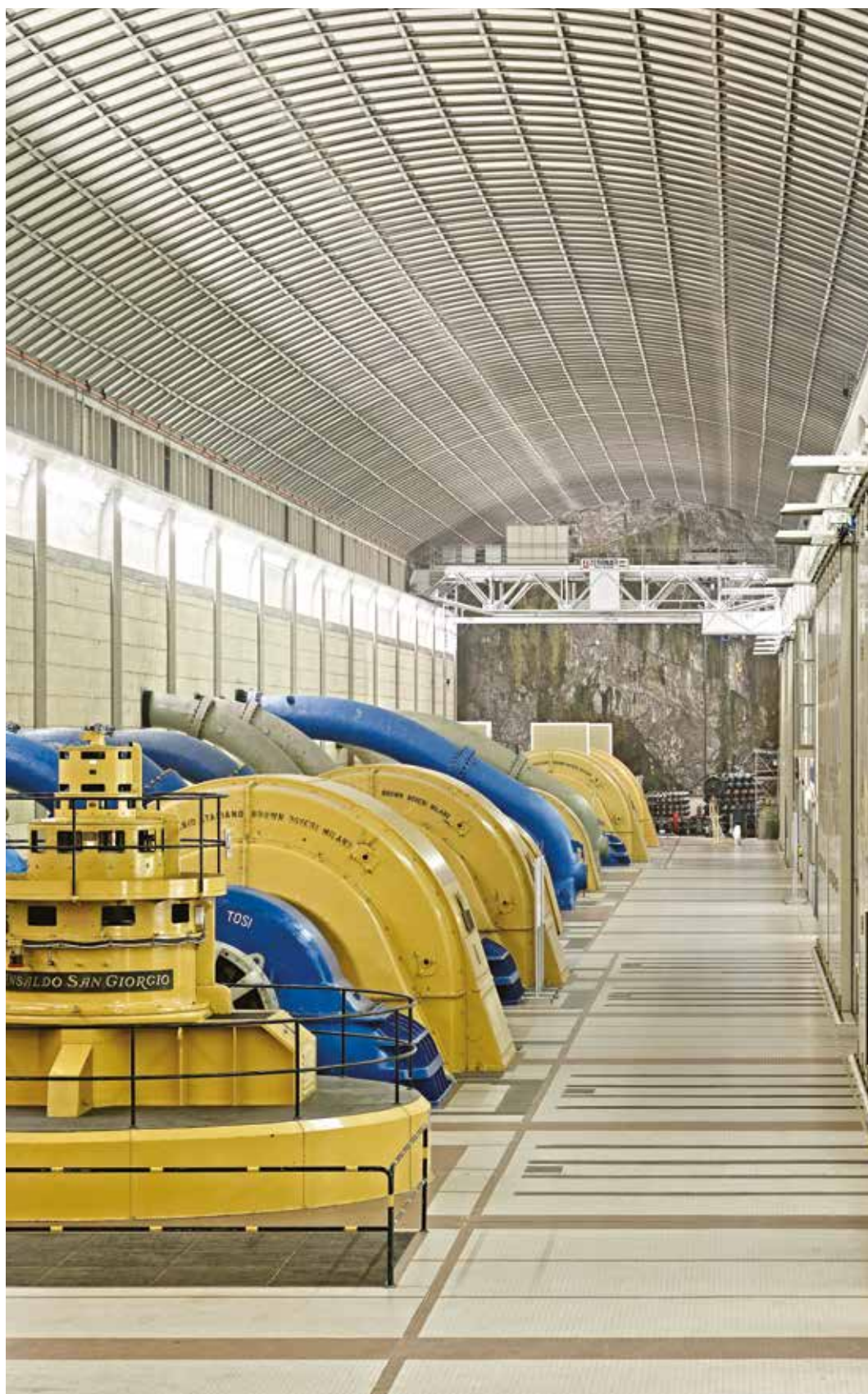
Centrale idroelettrica di Santa Massenza
